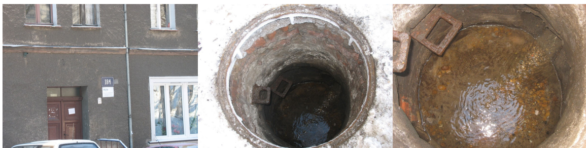
studnia D7 – lokalizacja w chodniku, właz typu lekkiego w stanie dobrym, cała komora studni w złym stanie technicznym (zalecana naprawa),
