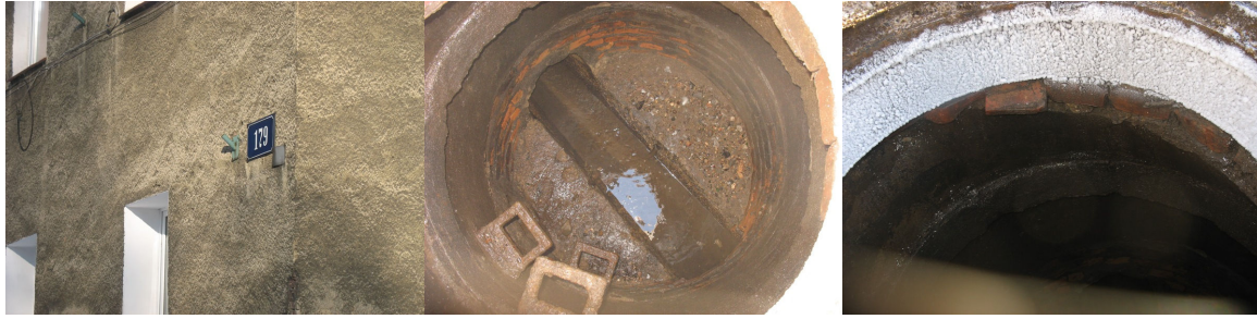
studnia D5 - lokalizacja w jezdni, właz żeliwny starego typu (zalecana wymiana), komin i komora studni w dobrym stanie technicznym,
